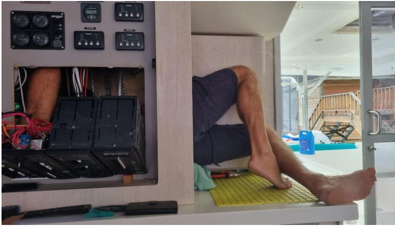
Foto oben: Arbeiten an unzugänglichen Stellen wie hier hinter dem Schaltkasten sind schweißtreibend.
